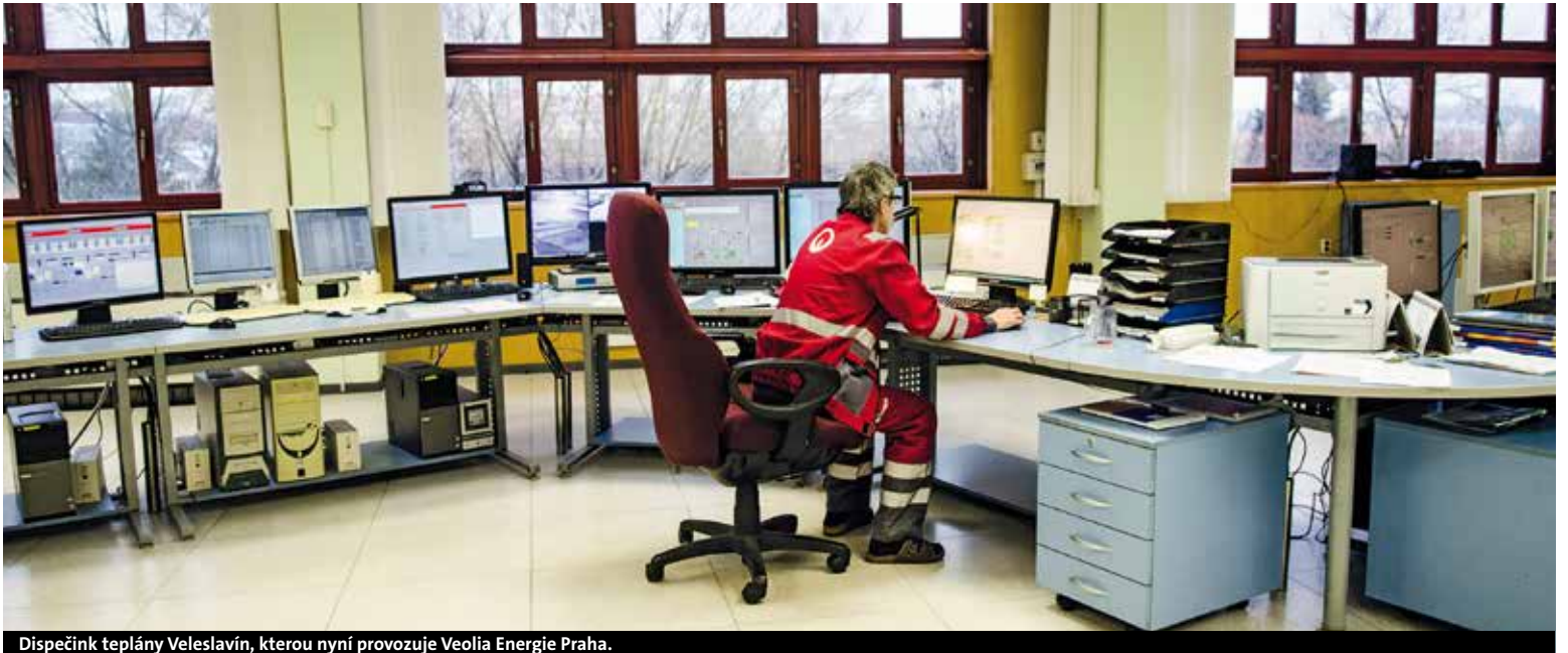
Dispečink teplárny Veleslavín, kterou nyní provozuje Veolia Energie Praha.
