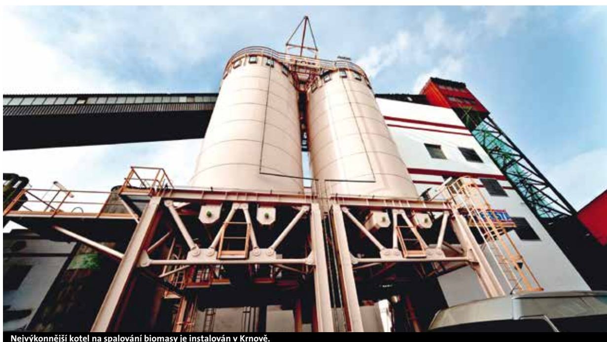
Nejvýkonnější kotel na spalování biomasy je instalován v Krnově.
